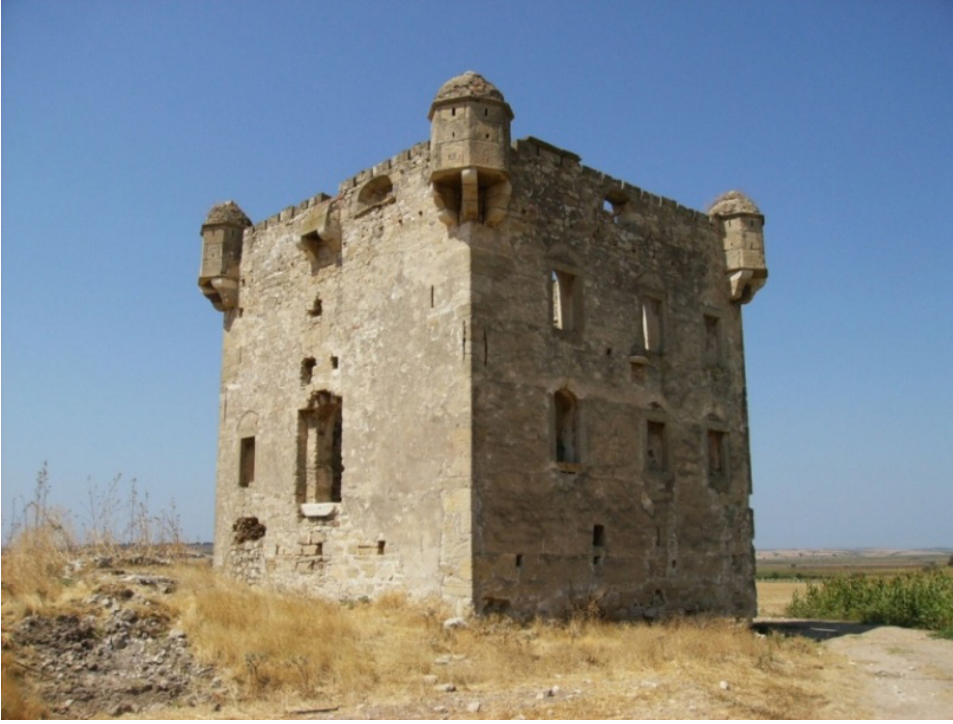
Şekil: 4 Cezayirli Hasan Paşa Kışkısı, yoğun tahribata maruz kalan anıt eserlerden biridir (2015).
